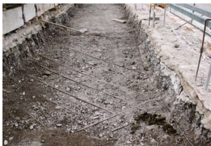
Obr. 11: Místo, kde byla při poslední opravě položena výztuž, k betonáži už ale nedošlo
